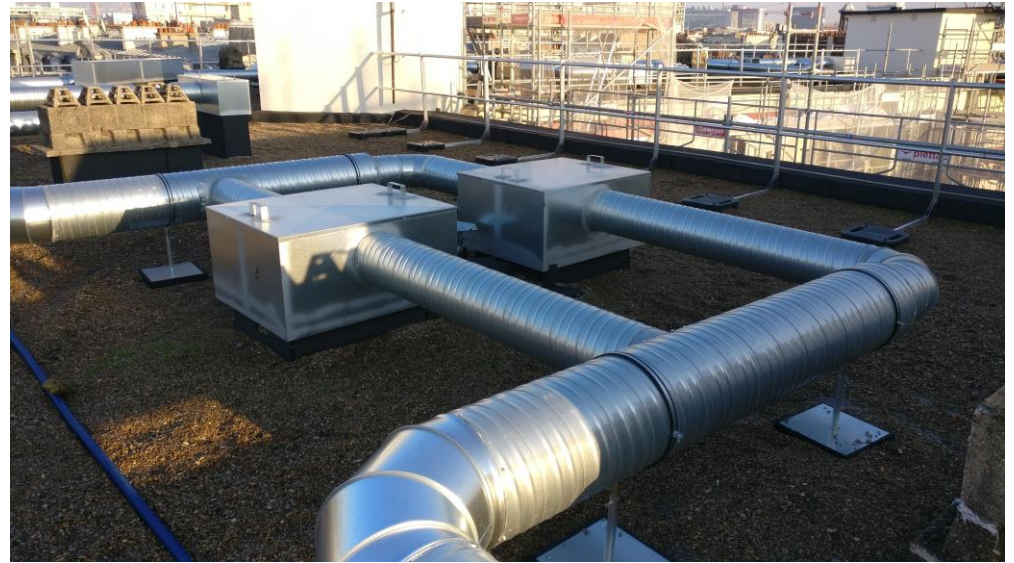
Mise en place d'une ventilation basse pression hygroréglable de type B
